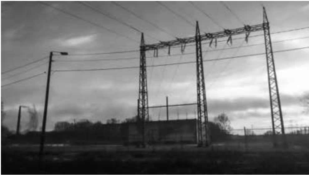
Kuva 6.2. Matkalla keskukseseen: sähköpylväitä.
